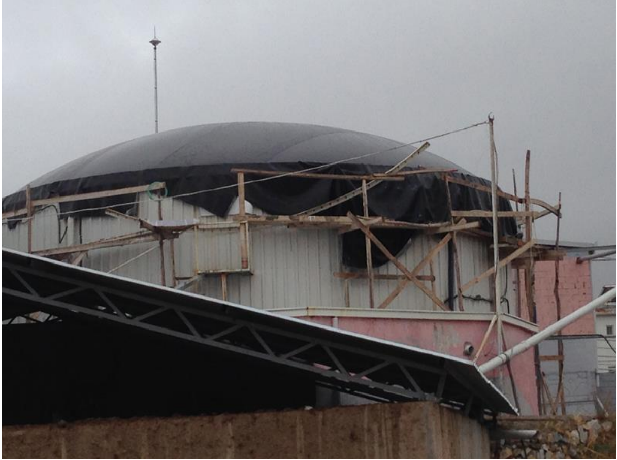
Resim 8. 100 kW Kapasiteli Biyogaz Tesisi-1
