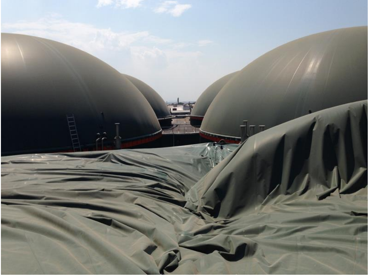
Resim 5. 2,2 MW Kapasiteli Biyogaz Tesisi-1
