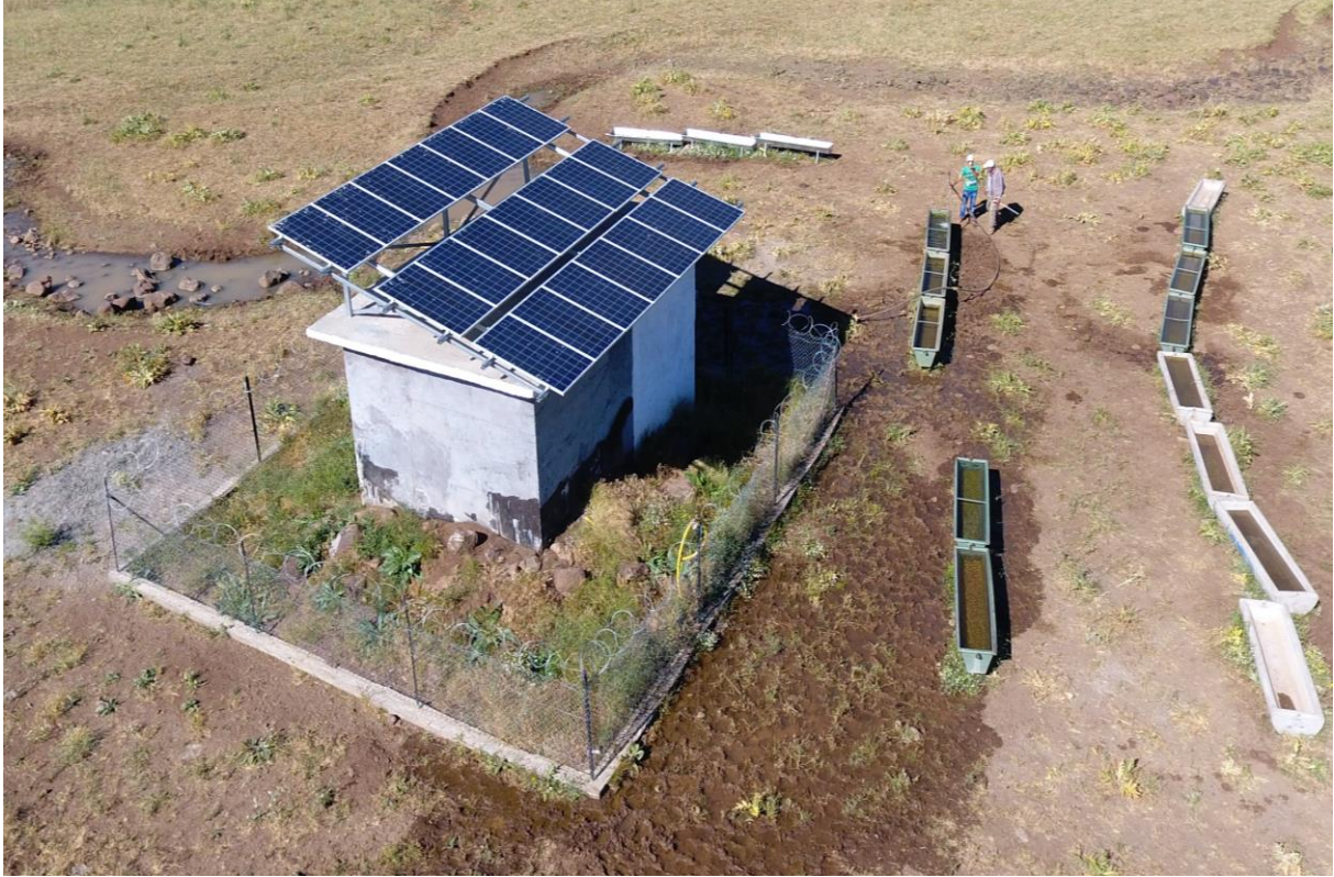
Resim 16: Güneş Enerjili Hayvan İçme Suyu Projesi- Karakoçan Kolundere (Elazığ)
